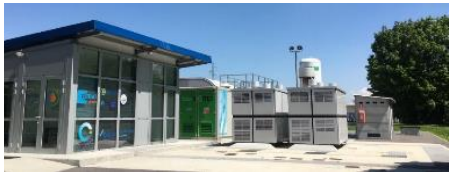
L'impianto DEMOSOFC, esempio reale di sistema con fuel cell alimentate a biogas. In figura sono visibili 2 moduli da 50 kW.
